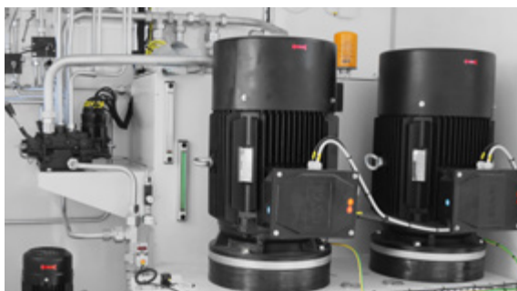
Hydraulik-Zentraleinheit jeder Landebrücke.
