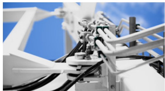
Stahlleitungen und Hydraulikschläuche sorgen für den Betrieb der Landebrücken.
